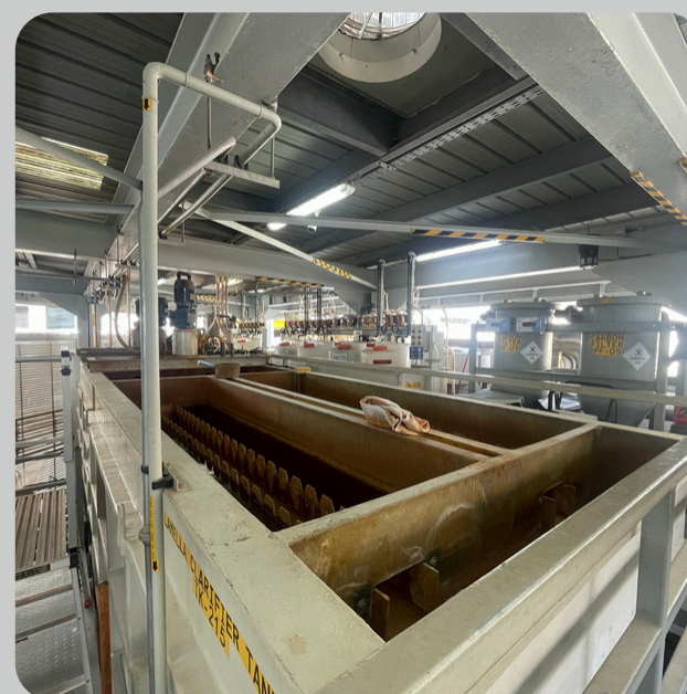
二期污水處理廠： 每日處理量 最高可達 170立方米的污水
