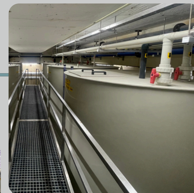
五期污水處理廠： 每日處理量 最高可達 120立方米的污水
